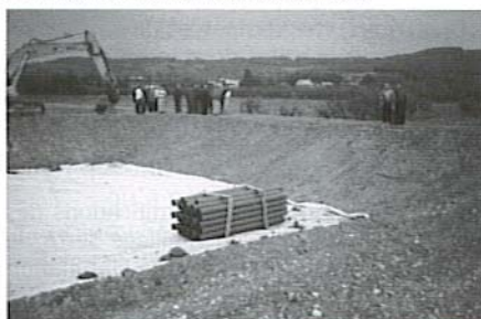
Station d'épuration d'Albon (France), 15000 EH – 3750 m 2 de roseaux plantés dans 8 lits de séchage. Mise en service en 2003. Conception et réalisation Bureau SINT
