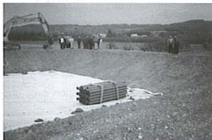
Station d'épuration de Civrieux (France), 750 EH – 250 m 2 de roseaux. Mise en service en 2002. Conception et réalisation Agence SDIE
